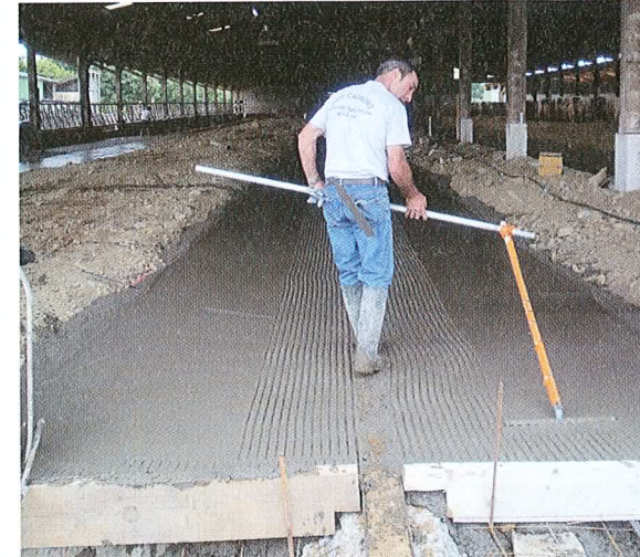
3 - Le rainurage des couloirs. « Il a été fait directement par l'entreprise de maçonnerie au moment du passage en logettes, sur ciment frais, avec un râteau. Pas de glissades dans les couloirs.
